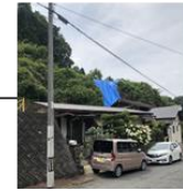
千早赤阪村東阪 法面崩壊
