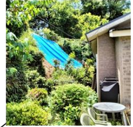
四條畷市下田原 法面崩壊
