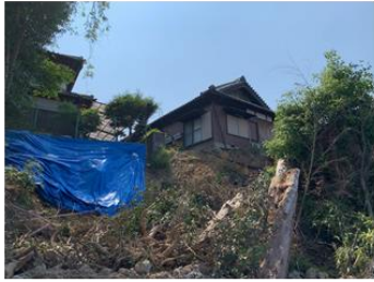
和泉市上代町 法面崩壊
