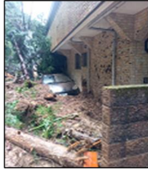
和泉市春木川町 道路法面表層崩壊
