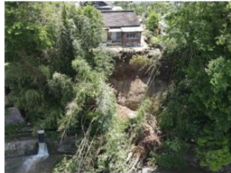
和泉市仏並町 榎尾川法面崩壊
