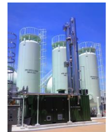
③新型バイオガス精製装置
