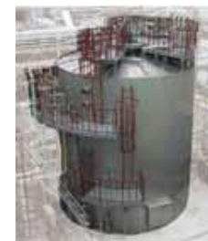
②鋼板製消化槽
