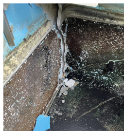
浄水場沈澱池の躯体ひび割れ
