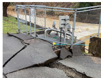
浄水場取水口の損傷
