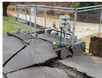
浄水場取水口の損傷
