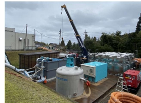
可搬式浄水施設・設備（珠洲市）
