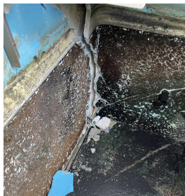
浄水場沈澱池の躯体ひび割れ
