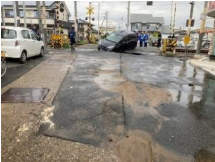
【道路陥没状況】
