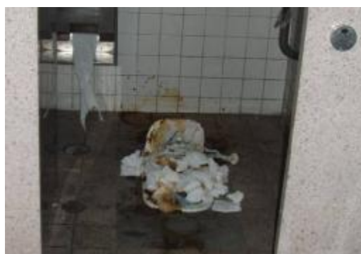
地震後のトイレの状態
