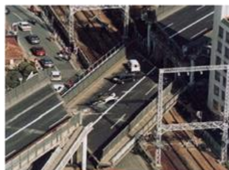
上部構造の落橋
