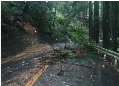
(例) 法面崩落、倒木
