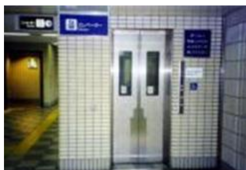
エレベーターの設置状況
