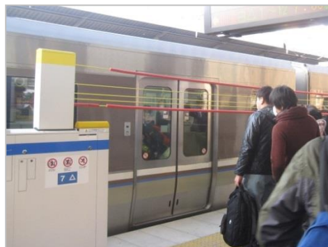
昇降式ホーム柵の設置状況(ロープ式)
