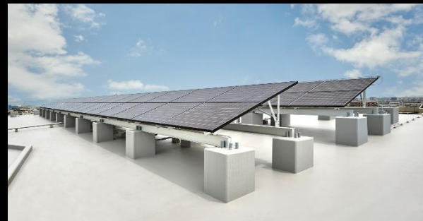
太陽光パネル
