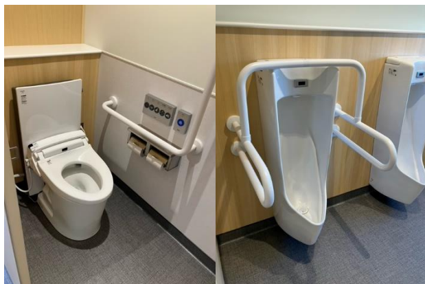
雨水を便所洗浄水に利用
