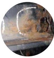
現水門の腐食状況
