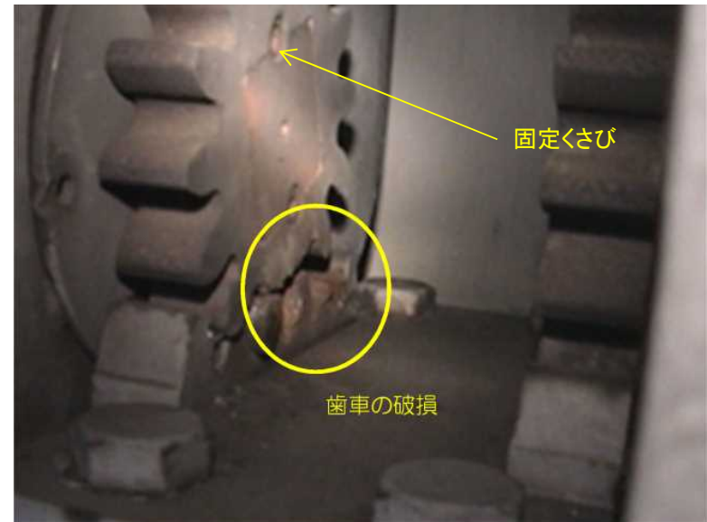
写真-2. 歯車の破損例
