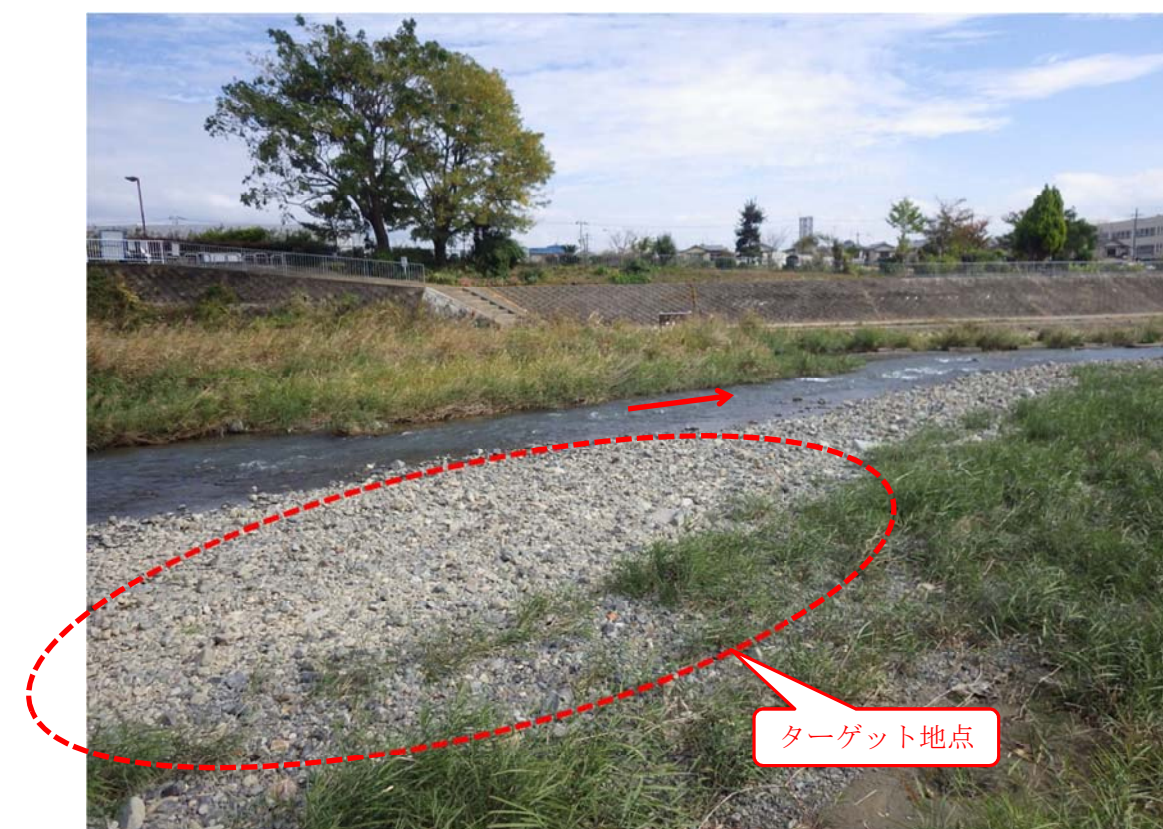
土室川放水路合流点（14.6k 付近）に堆積した砂州（ターゲット地点）
