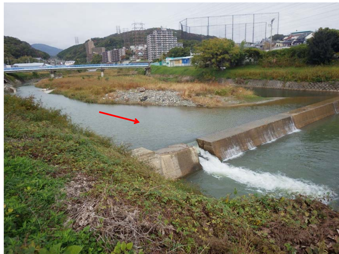
是推橋下流の落差工(14.9k 付近)上流に堆積した砂州(植生が繁茂)
