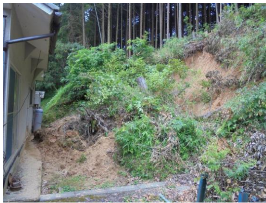
◆災害報告の事例（河内長野市日野）
