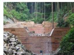
小規模治山ダムの階段状配置
