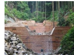
小規模治山ダムの階段状配置
