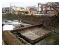
築工・水叩工損傷
