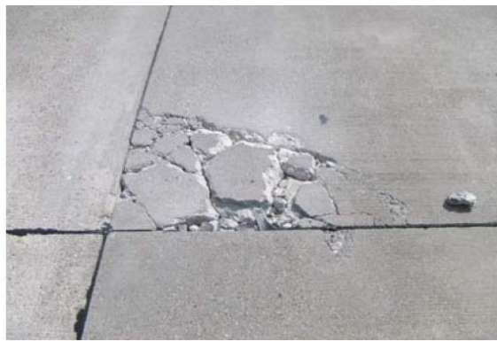
コンクリート舗装の角欠け
