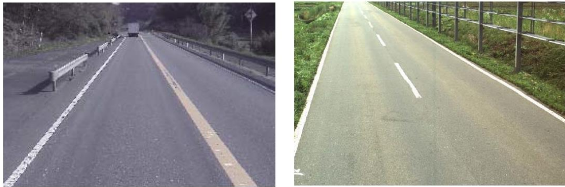
図3-4 わだち掘れ発生状況写真(1)
