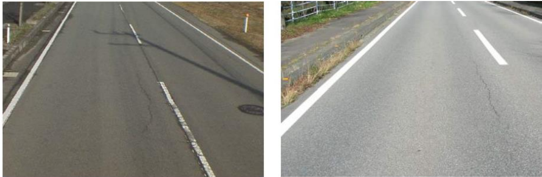
図3-1 ひび割れ発生状況写真(1)
