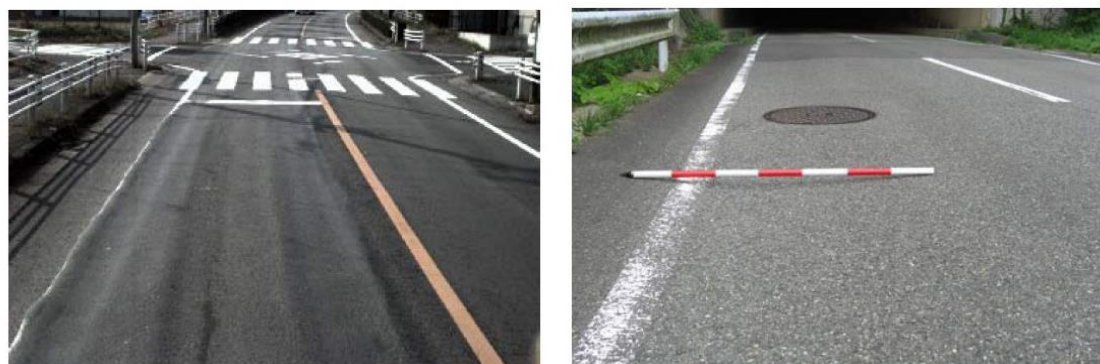
図3-5 わだち掘れ発生状況写真(2)
