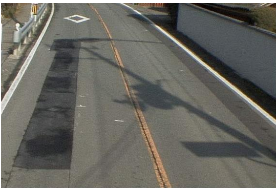
占用復旧跡の沈下
