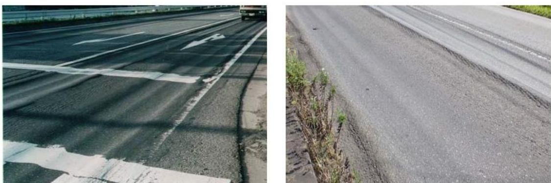
図3-6 わだち掘れ発生状況写真(3)
