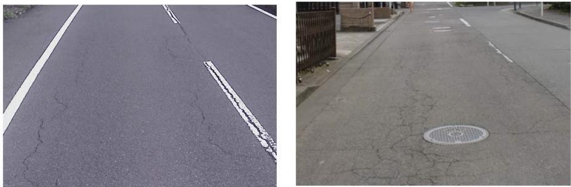
図3-2 ひび割れ発生状況写真(2)
