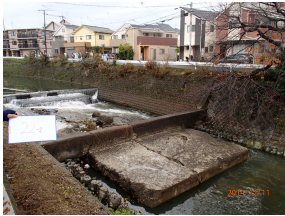
帯工・水叩工損傷
