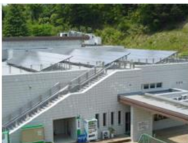
太陽光発電システム
