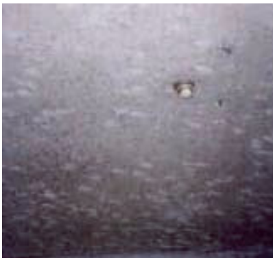
吸音・断熱材（機械室の壁・天井）
