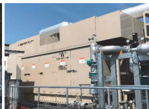
コージェネレーションシステム
