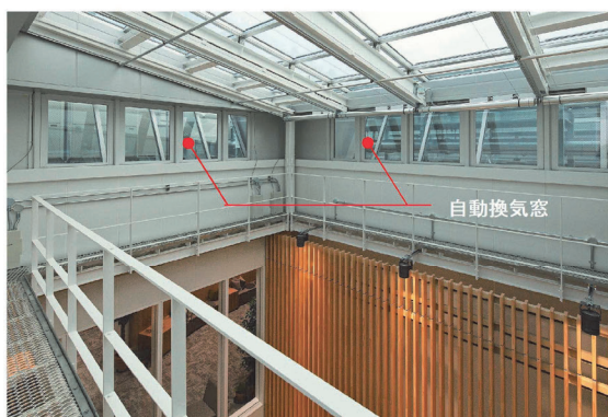
吹抜上部のトップライト、自動換気窓
