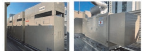
図-5 マイクロコージェネレーションと非常用発電機
