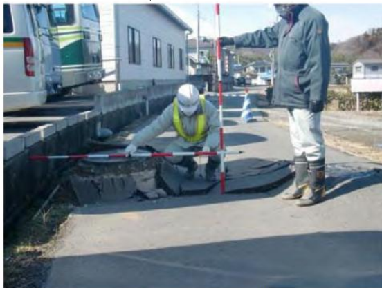
人孔突出、路面異常
