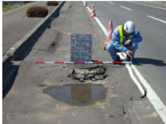
人孔突出、路面異常
