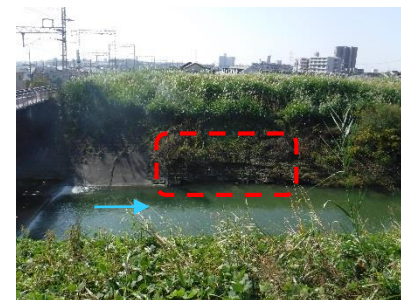
平成29年10月豪雨被害:船橋川 (京阪本線下流)
