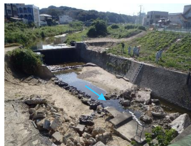
平成24年8月豪雨被害:穂谷川 (国道1号上流)
