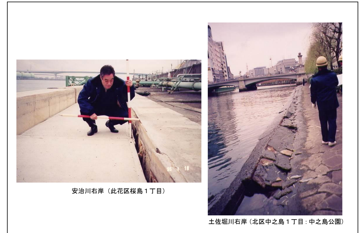
図 1.81 兵庫県南部地震による対象河川の防潮堤損傷状況
