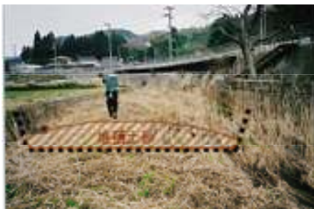
土砂堆積状況（対策前）
