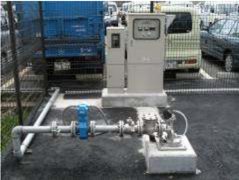
写真 1.7 地下水の導水(恩智川)
