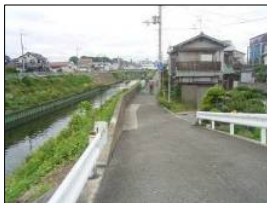
流下能力不足箇所
