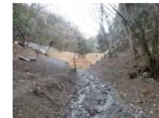
渓流沿いの危険木の除去
