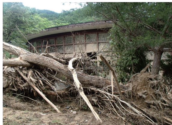
2018年7月豪雨による被害（能勢町）
