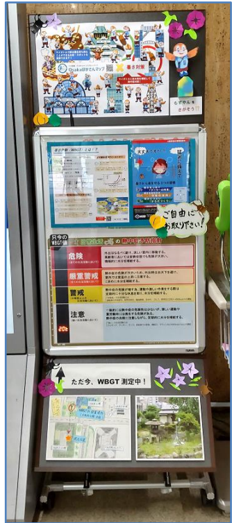
【図 3】WBGT（暑さ指数計）の電光表示パネルの設置
