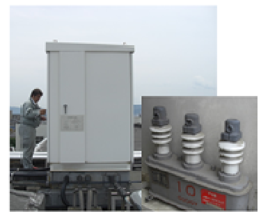
P C B（コンデンサ）保管状況の立入検査
