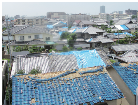
屋根瓦に被害のあった住宅
