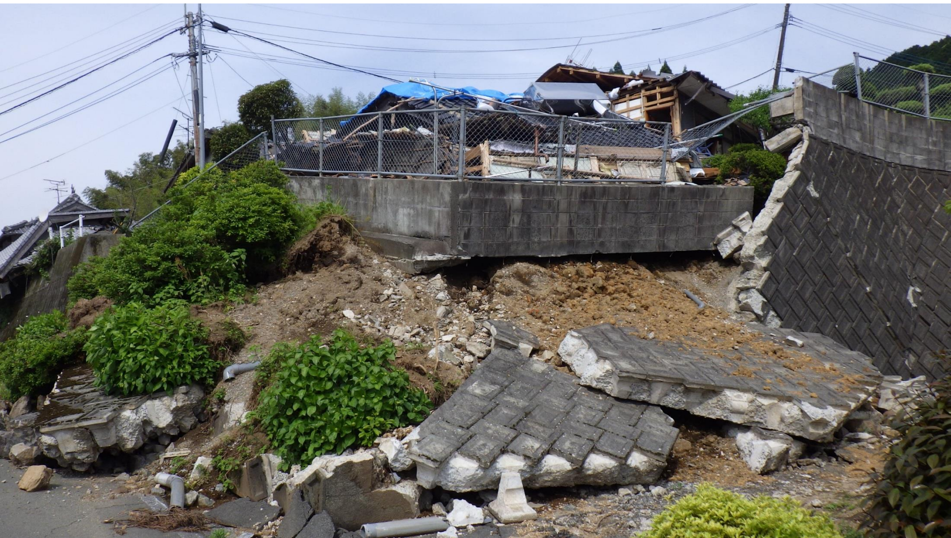
地震による練積ブロック擁壁の崩壊状況
