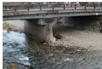
水位カメラ・大川橋 (榎尾川・仏並町)
