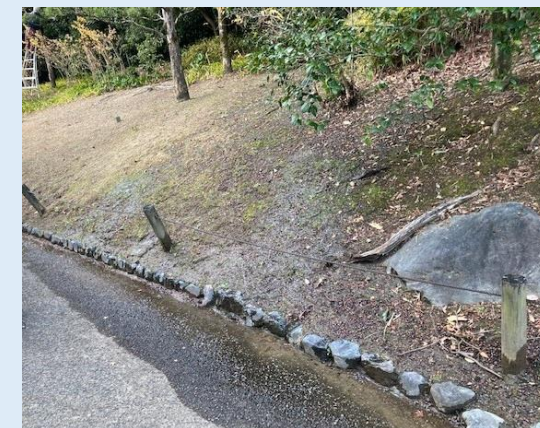
②水系設備の漏水
