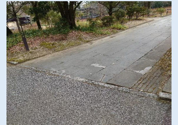
③園路の舗装劣化
