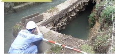
【R2.7月豪雨】 (熊本県錦町)
