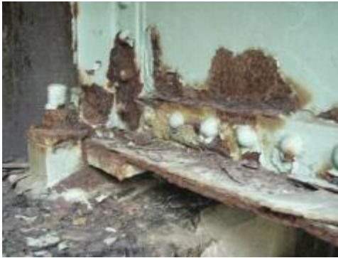
《下フランジ上面の腐食》
