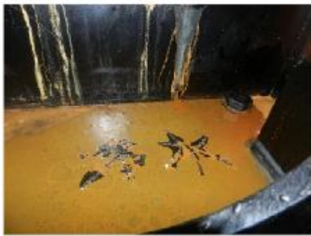
箱内部の滞水
