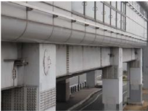
外壁の塗膜の劣化
