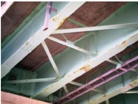
《下フランジ下面の腐食》
