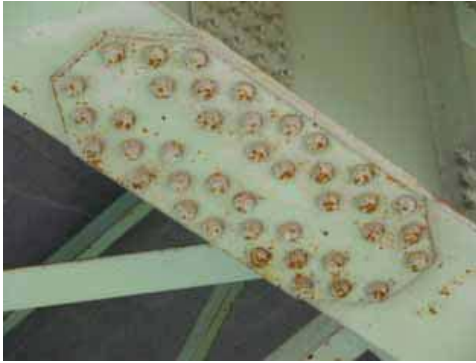
《添接部の腐食》
