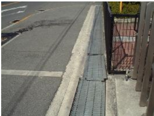
写真 2.1-2 側溝の蓋のはずれ
