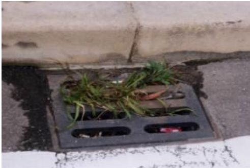
《目詰まりの様子》
