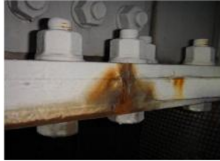
添接部の局所的な腐食
