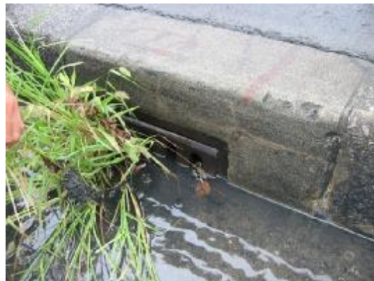
写真 2.1-3 排水口の詰り
