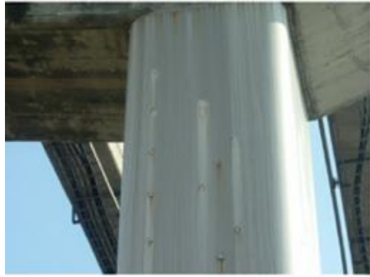
耐震補強材の劣化
