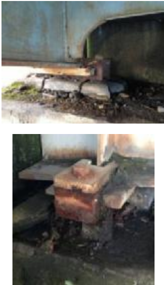
支承の損傷状況
