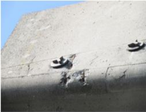
剥離・鉄筋露出
