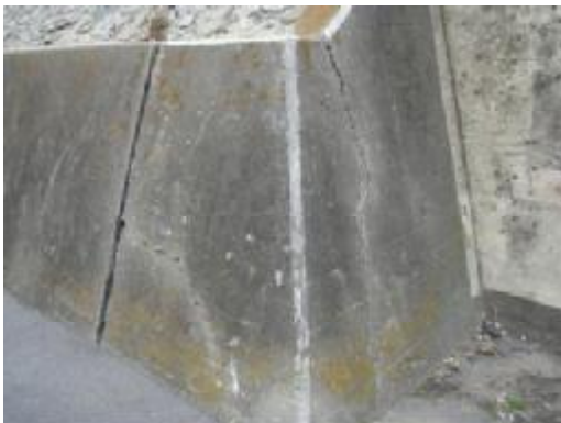
擁壁クラック
