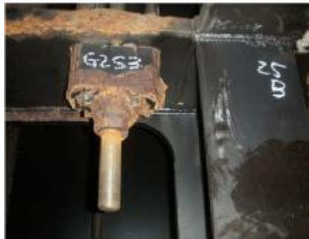
支承アンカーボルト受けの腐食
