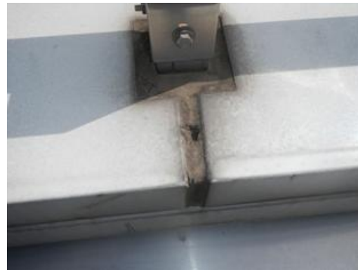
シーリング材の劣化
