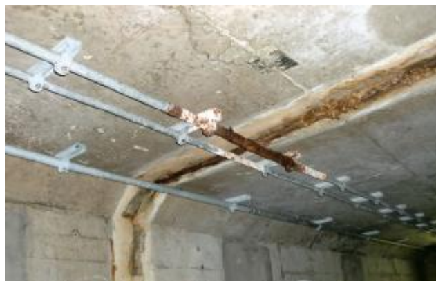
写真 2.1-1 最も古い共同溝と継ぎ目からの漏水と付帯管路の腐食状況
