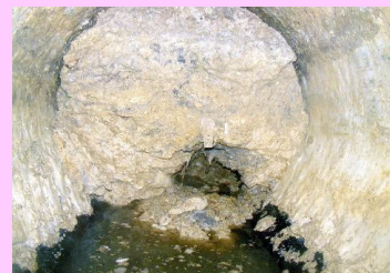
油分で完全に詰まった下水道管
