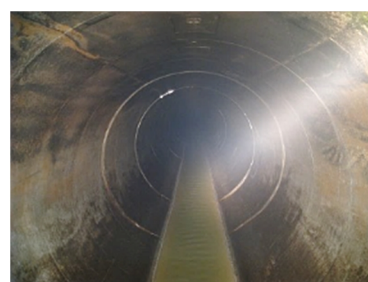
下水道管の中を汚水が流れる様子
