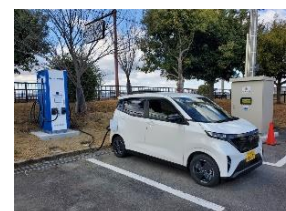
府有施設への充電設備の設置
