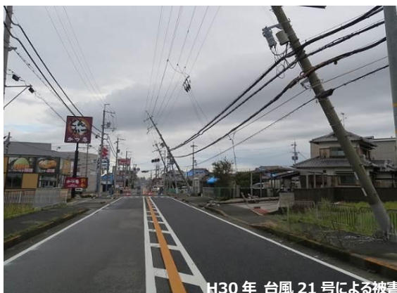
H30年 台風 21 号による被害 （府道 泉佐野岩出線）
