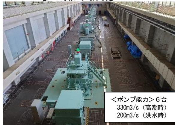
【毛馬排水機場】
