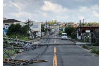
倒壊による道路閉鎖
