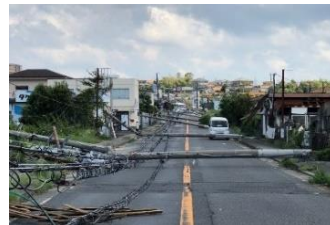
倒壊による道路閉鎖
