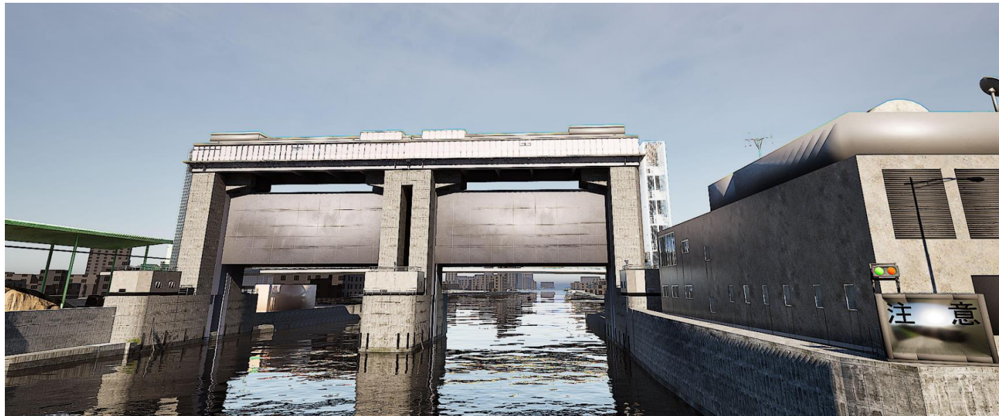
劣化後 (50年程度経過)
