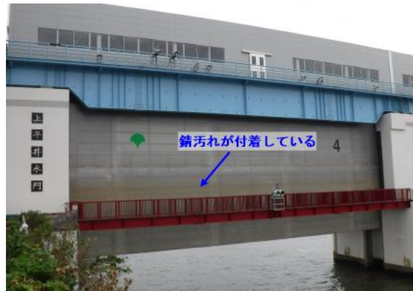
上平井水門(4年経過)
