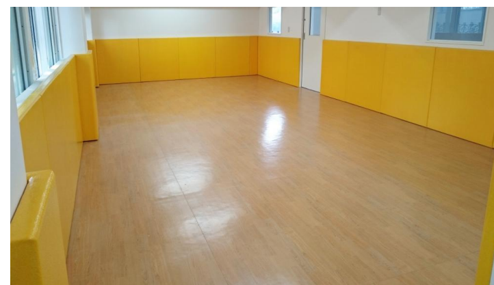
壁：防護マット (高さ2mまで)
