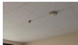
天井 岩綿吸音
