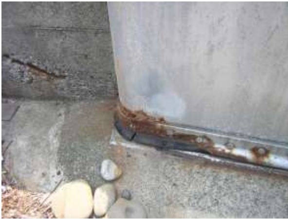
水密ゴムの亀裂
