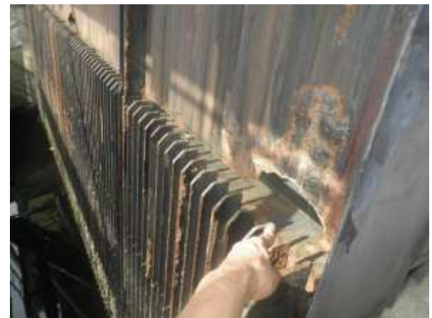
除塵機の腐食
