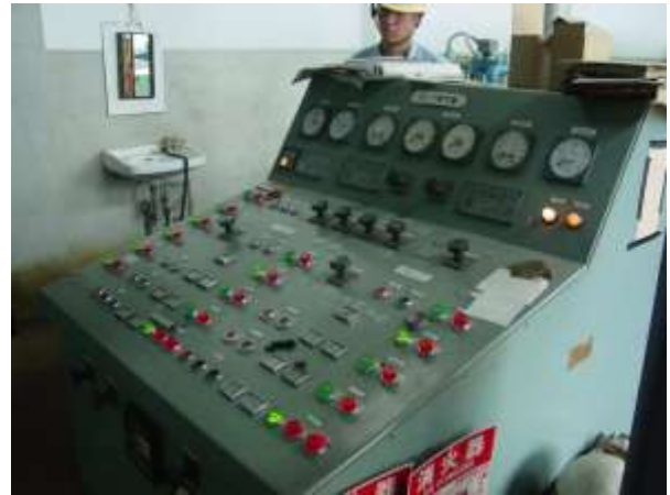
電気設備の陳腐化
