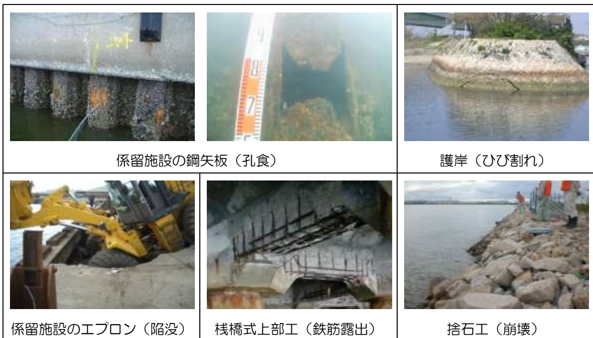
写真 2.1-1 主な港湾施設の劣化状況
