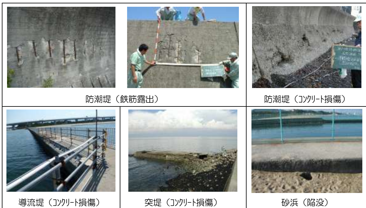
写真 2.1-2 主な海岸施設の劣化状況
