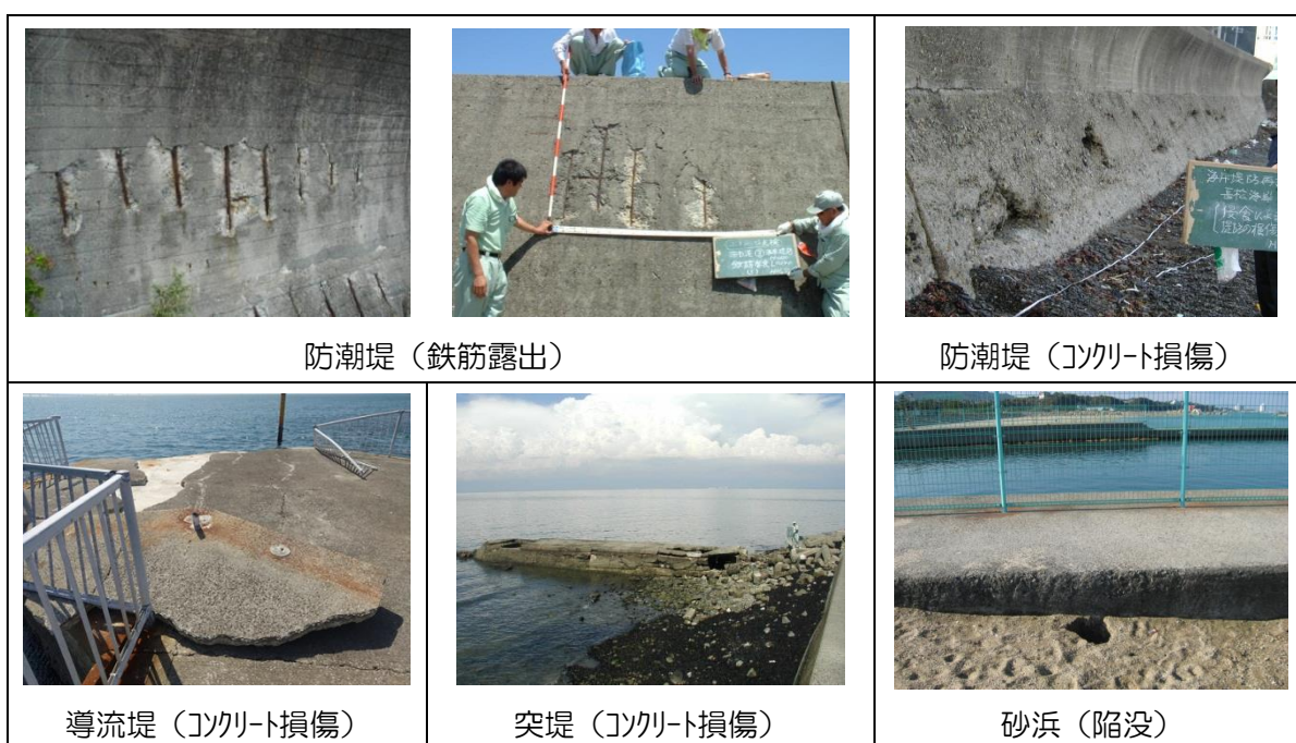
図 3.1-9 主な海岸施設の劣化状況
