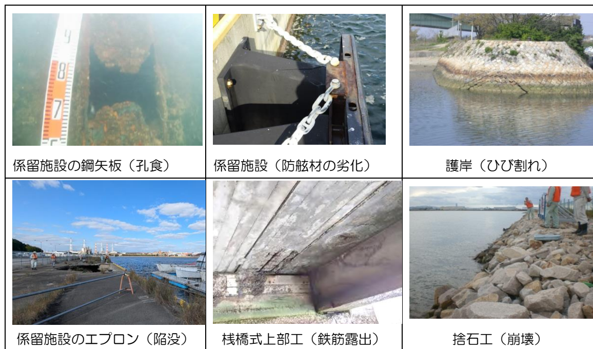
図 3.1-5 主な港湾施設の劣化状況
