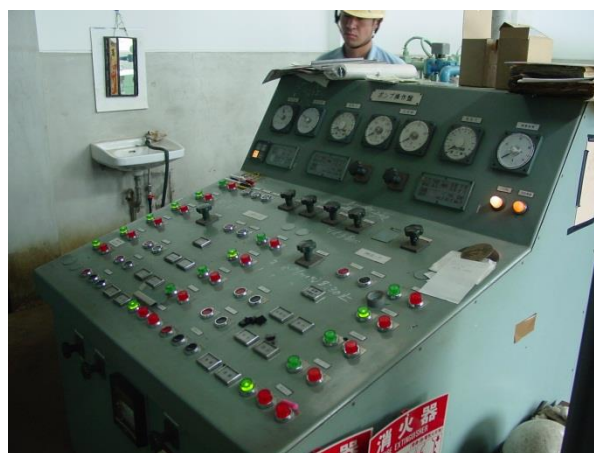
電気設備の陳腐化
