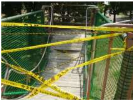
劣化による破損（利用停止）
