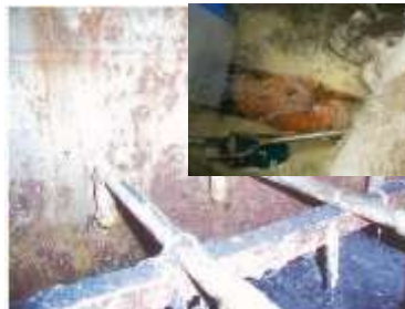
耐用年数超過、濾過装置の腐食、配管の漏水
