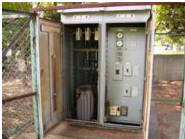
耐用年数超過盤の腐食
