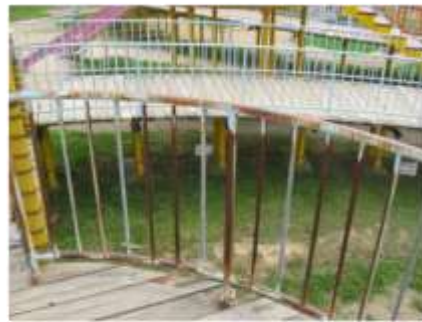
劣化による腐食
