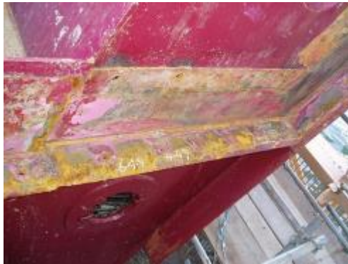
水門扉体の腐食状況
